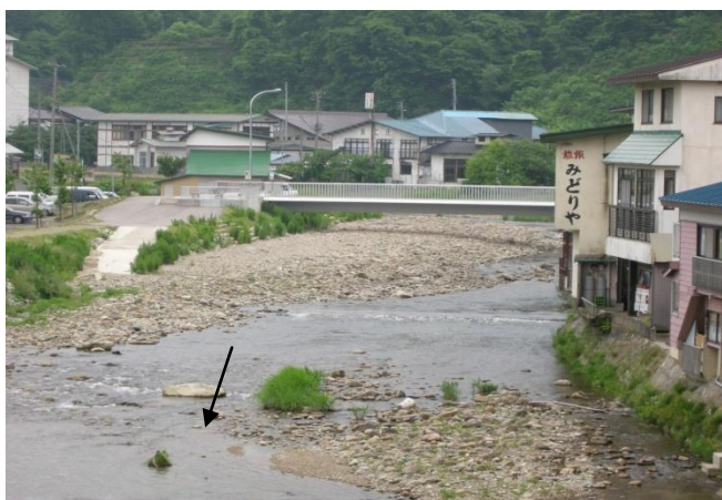
ゆけむり橋の右岸側 上下流に堆積した砂礫
