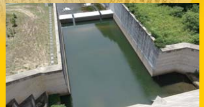
ダム本体と副ダムの間にヘドロや土砂が堆積していた。
