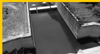
ダム本体と副ダムの間にヘドロや土砂が堆積していた。
